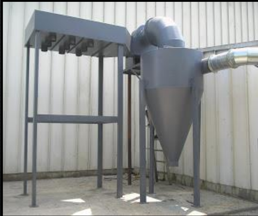
CÁMARAS DE SEDIMENTACIÓN
